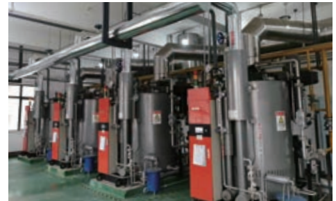
北京工廠燃氣鍋爐採用低氮燃燒器
